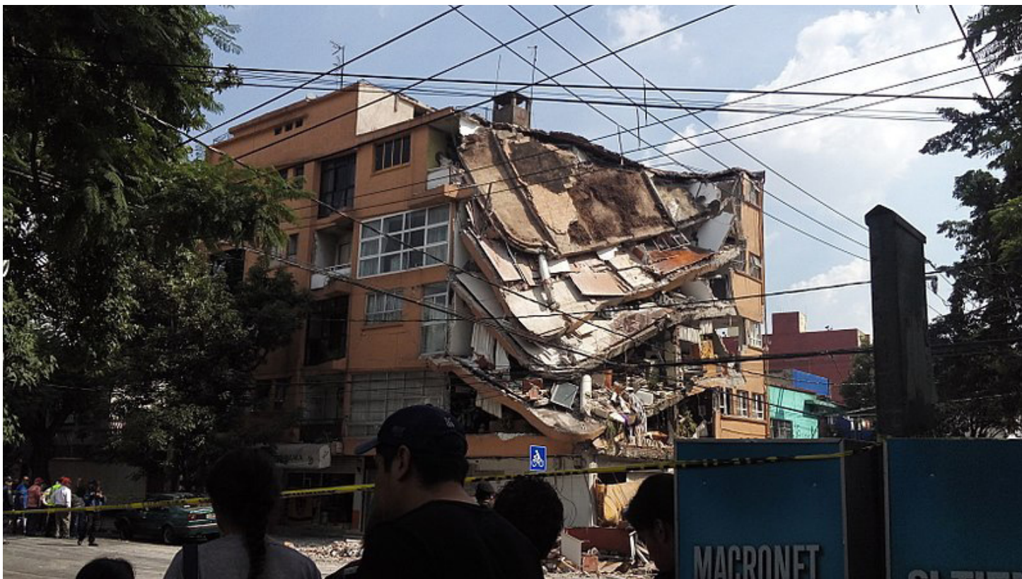
Bâtiment endommagé par le séisme de 2017 à Puebla.
